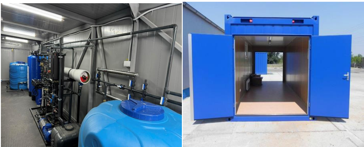
Рисунок 1 – Модульна установка водоочищення
